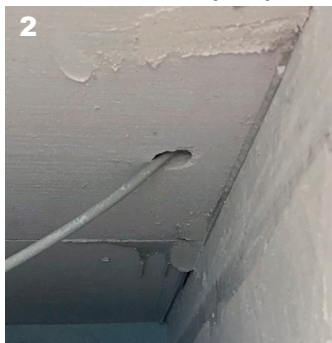
For stort et hul omkring ledningshullet, skulle have været fuget / Too much space around the wiring, must be grouted.
