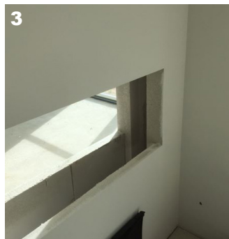
Pejsevæggen er ikke sikret mod falsk træk i siderne / The fireplace wall is not secured against false draft in the sides.
